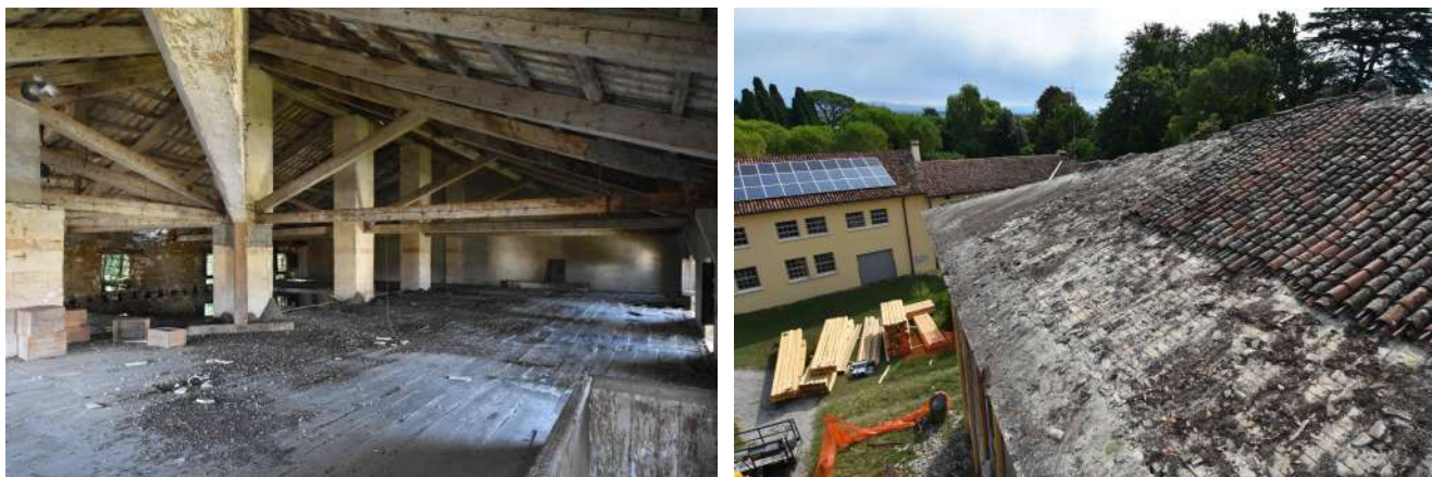
12-13_la copertura prima dei crolli e delle rimozioni di tavelle e coppi
