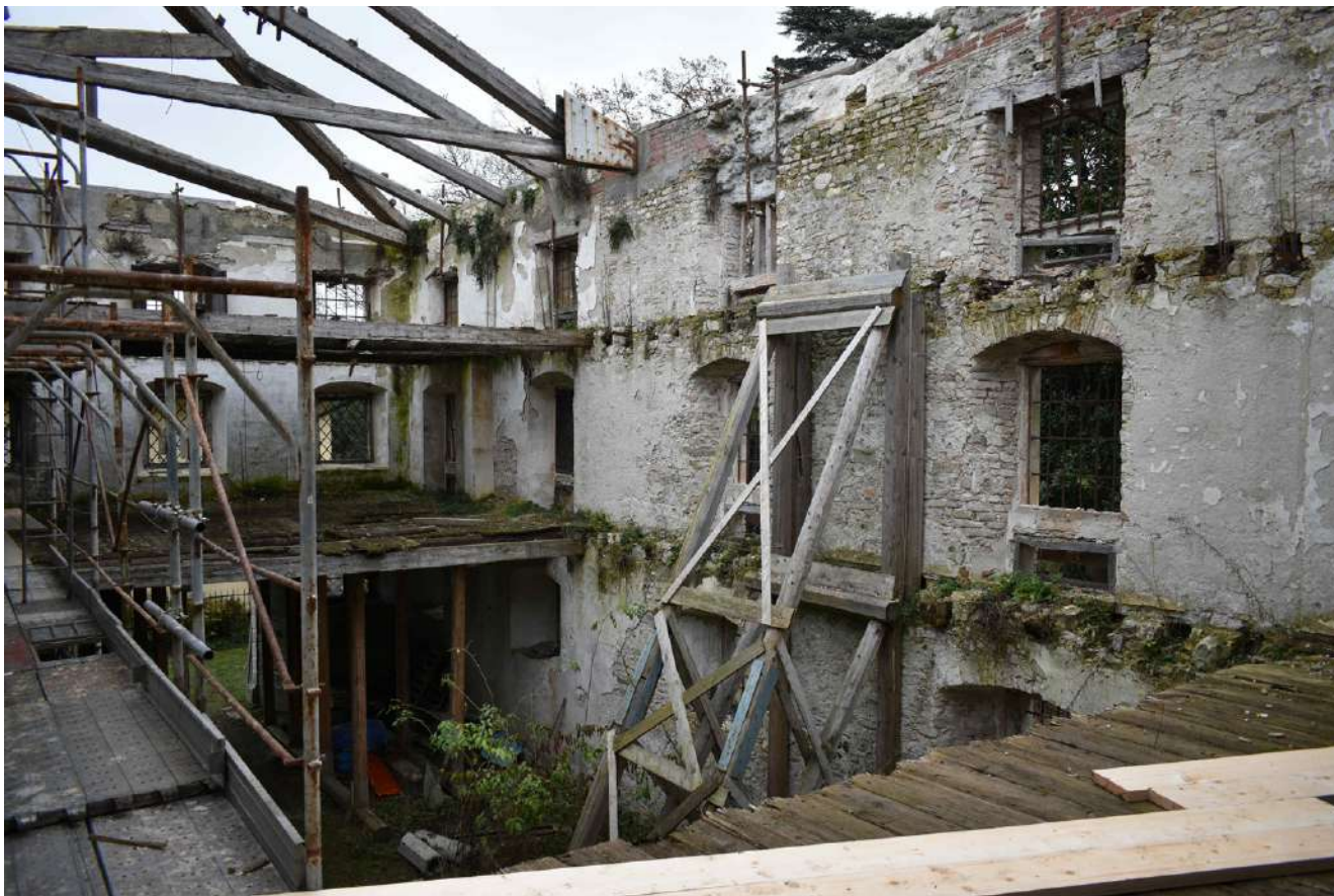
11_Le facciate interne, con la sequenza delle finestre differenti per ciascun piano
